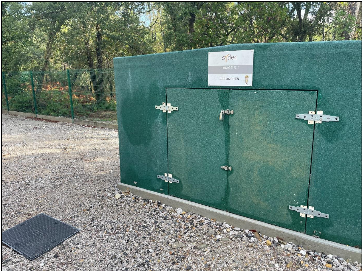
Figure 10 : Exemple de capot de protection mis en place par le SYDEC sur le forage R14bis (également situé sur le champ-captant de Ondres-Labenne) réalisé courant 2022
